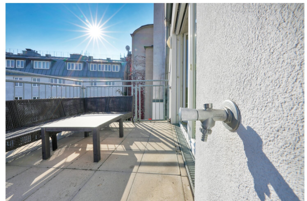
Kemperventil auf dem Balkon
