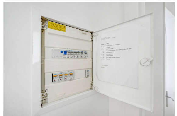
Elektro-Sicherungskasten Elektrobefund wird an den Käufer übergeben
