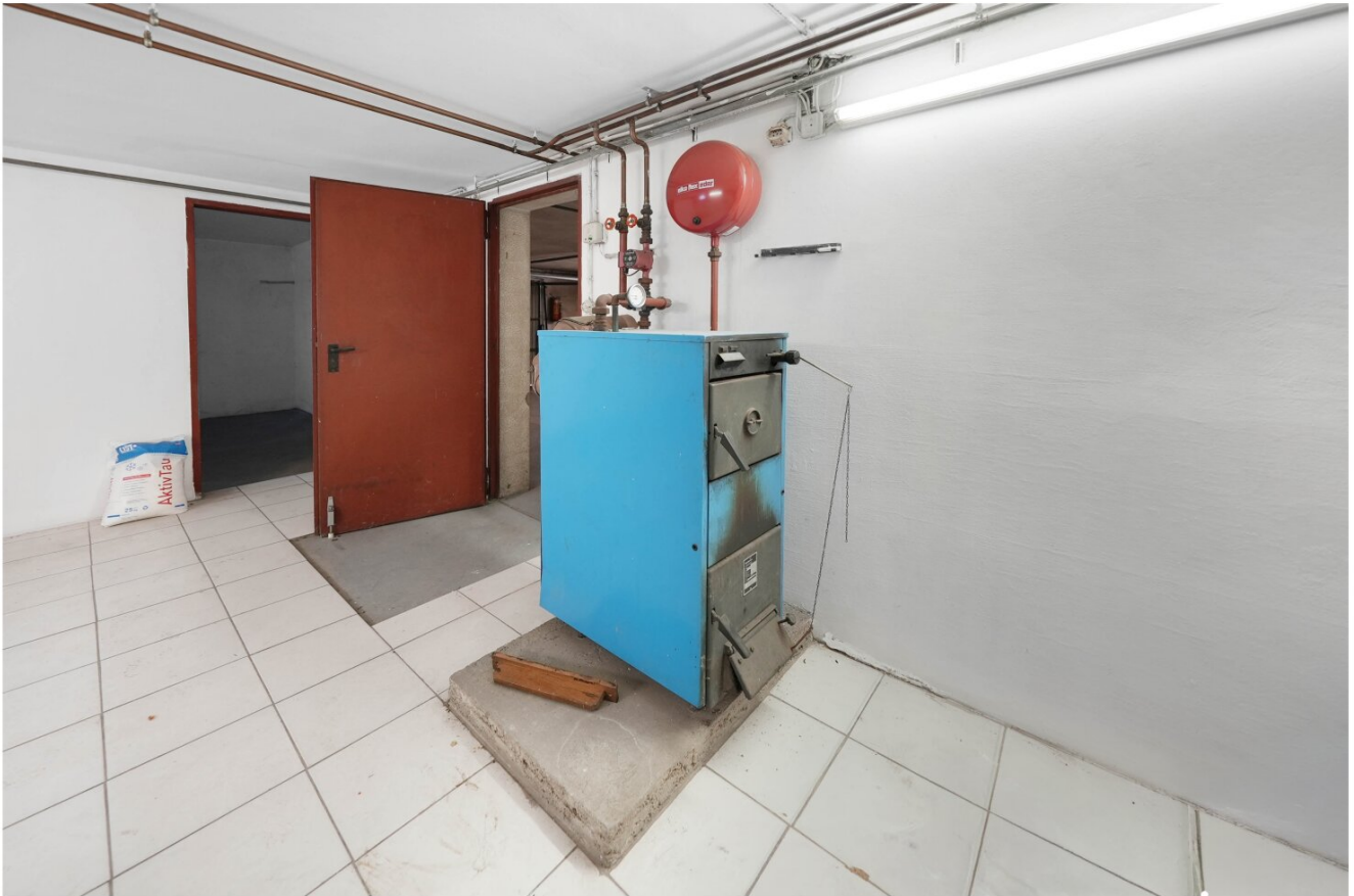
Stückgutofen im Keller & Gas-THERME in der Küche
