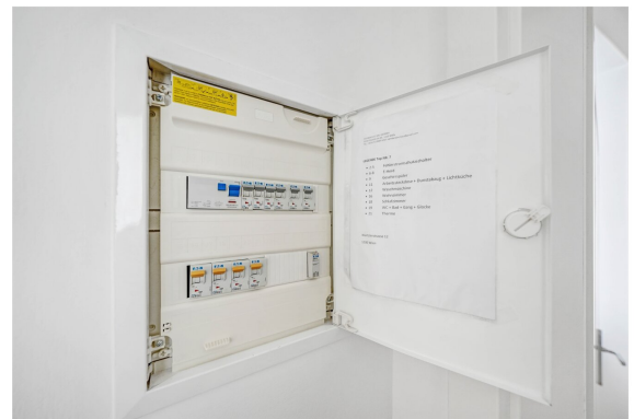
Elektro-Sicherungskasten Elektrobefund wird an den Käufer übergeben
