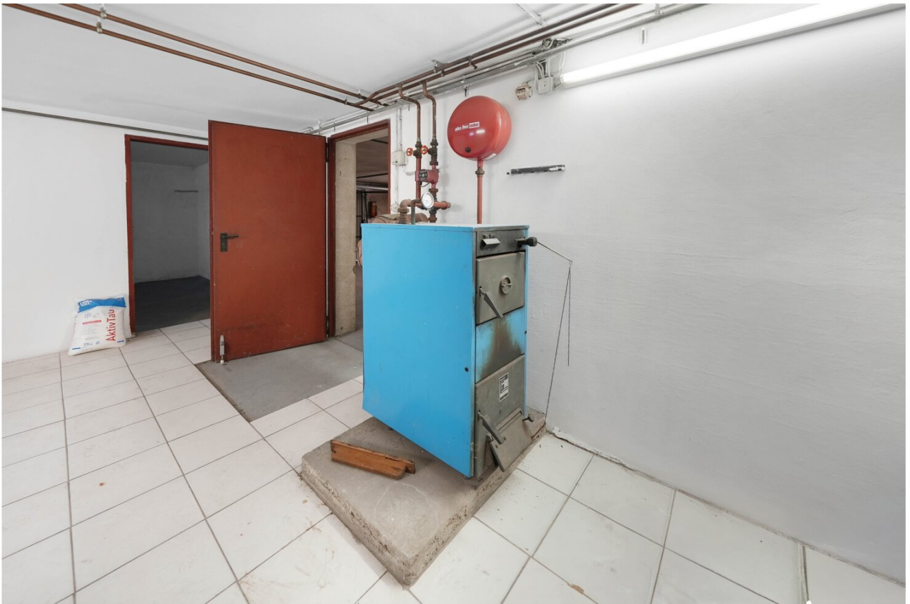
Stückgutofen im Keller & Gas-THERME in der Küche
