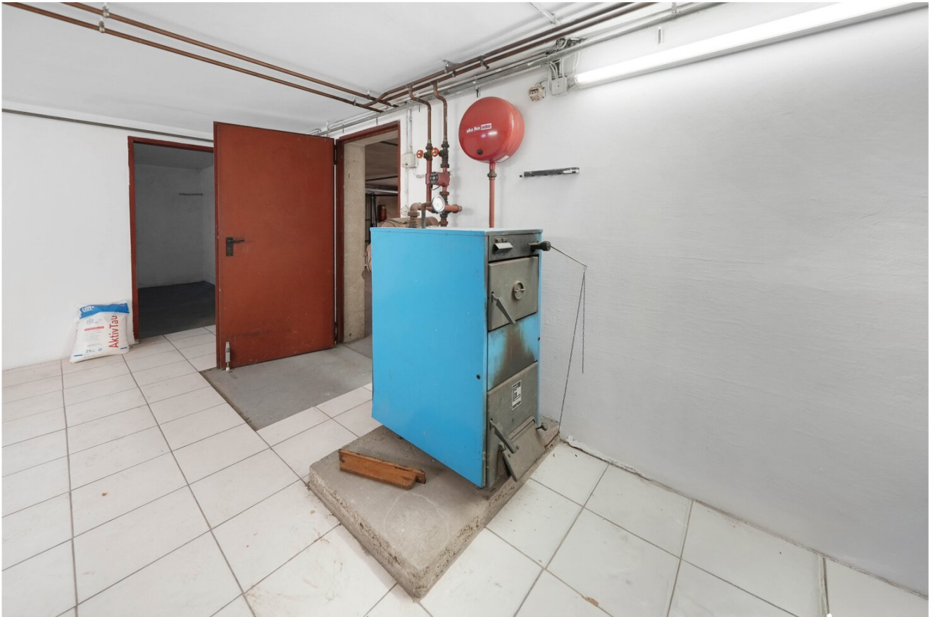
Stückgutofen im Keller & Gas-THERME in der Küche
