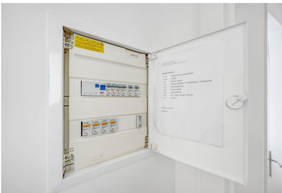
Elektro-Sicherungskasten Elektrobefund wird an den Käufer übergeben
