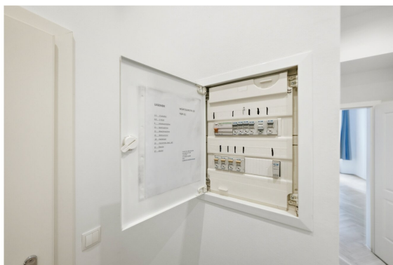
Elektro-Sicherungskasten Mit jeder Wohnung wird ein E-Befund übergeben
