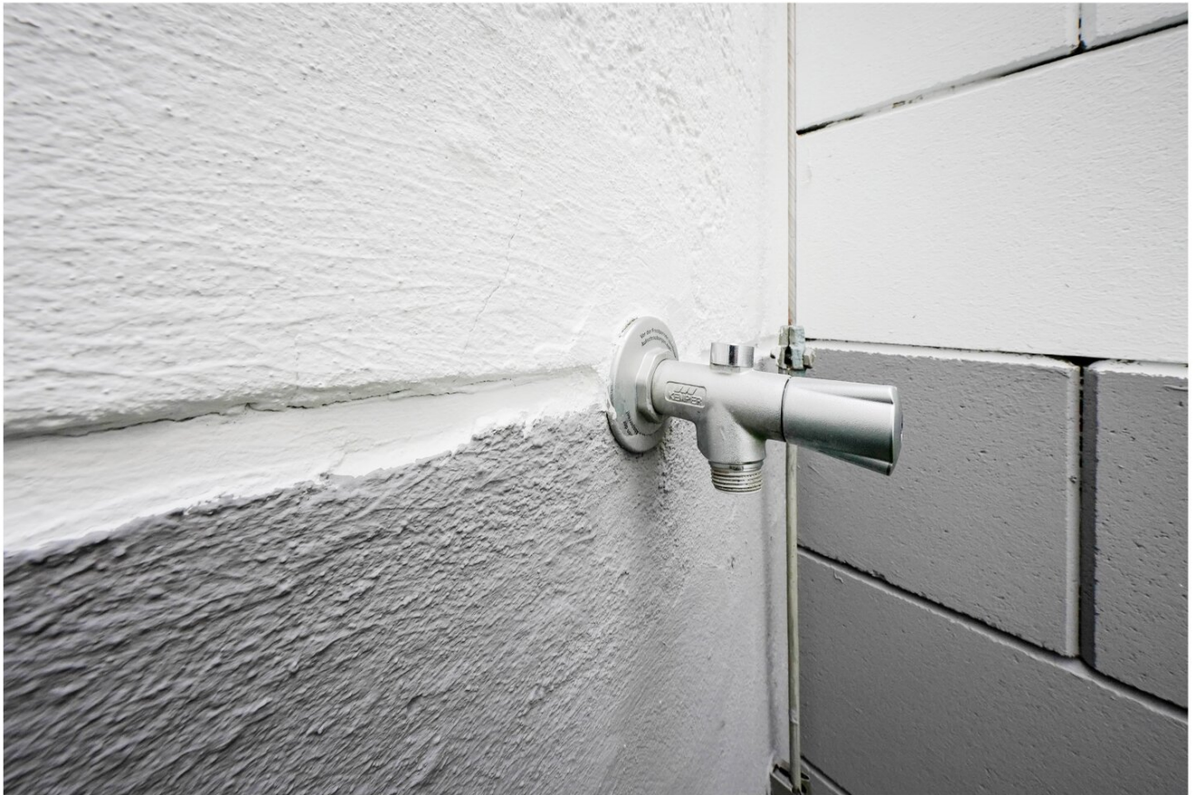
Wasserentnahmestelle (Kemperventil) auf der Terrasse
